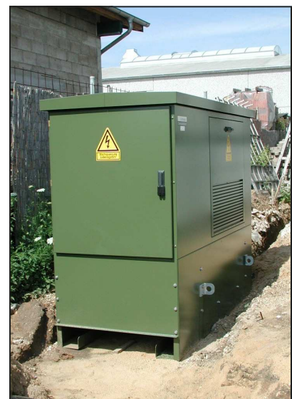
fundamentlos aufgestellte LCS-E
